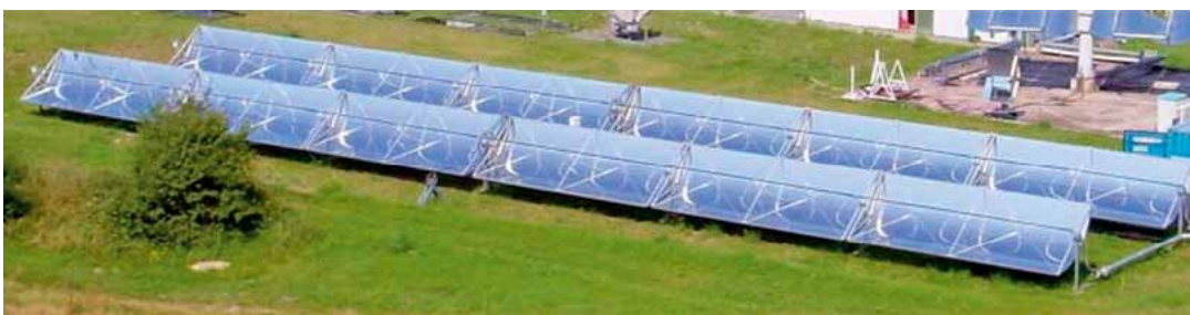
Abbildung 5 Parabolrinnenanlage des DLR zur direkten Prozessdampf- erzeugung
